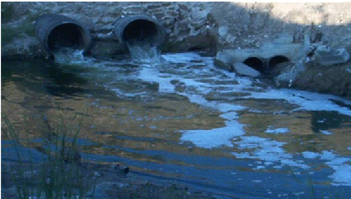
Figura 3.- Descargas de aguas residuales en el drenaje 20 de Noviembre
